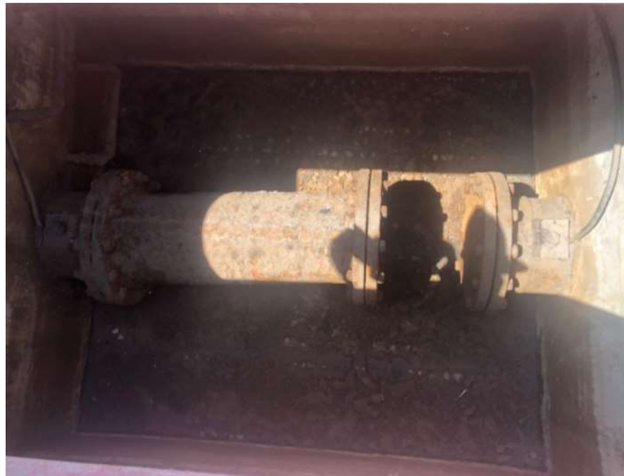
Foto 1. Registro tipo de válvula de seccionamiento (RT-03 y 08)
