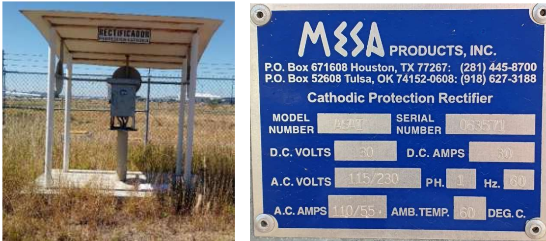
Foto 5. Rectificador de sistema de protección catódica existente
