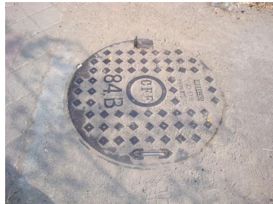
Foto 49. Servicio de electricidad disponible en la zona.
